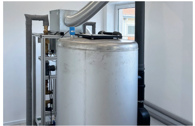
Kompakte Kombianlage: Im St. Georg Equestrian Club erzeugt die Grünbeck-Oxidationsfilteranlage fermaliQ:MB5000 mit Feinstaubfiltration einwandfreies Trinkwasser für die Pferde. Darüber hinaus enthärtet eine softliQ:LB70 das Wasser, sodass es sich auch perfekt für die Gastronomie eignet.
