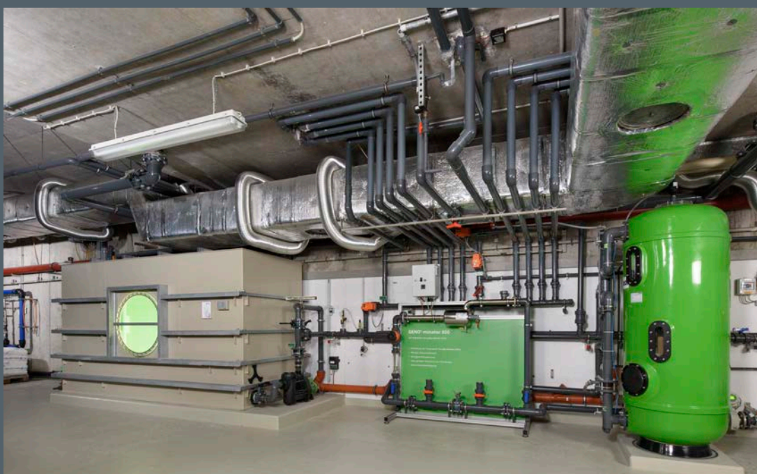
Planschbeckenwasseraufbereitung, GENO-mat BWK 800 A, GENO-minator, Rohwasserspeicher inkl. Beleuchtung.
