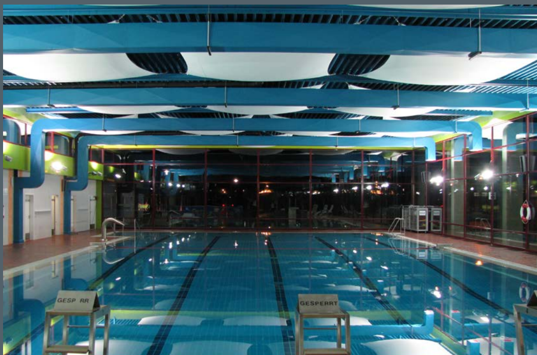
Hallenbad 25 m x 12,5 m Kombibecken, Planschbecken im Hintergrund
