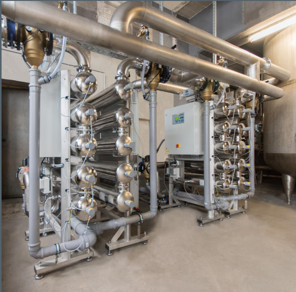
UV-Desinfektionsanlage bei der HOMANN Feinkost GmbH
