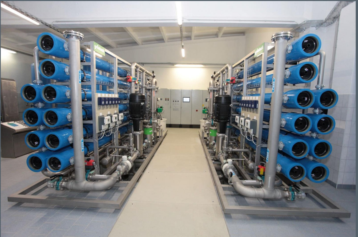
Umkehrosmoseanlagen und Schaltschrank
