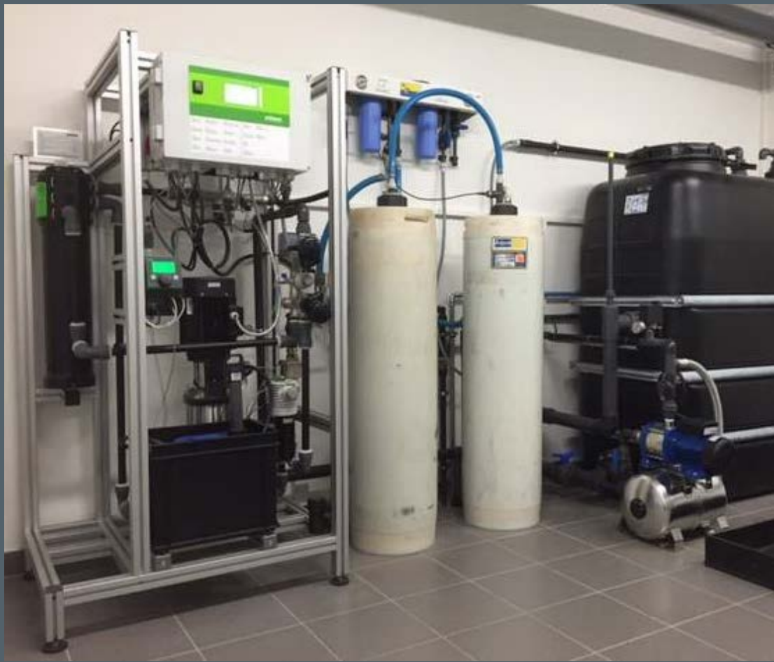
Osmoseur inverse, surpresseur et réservoir à perméat 2000 litres.
