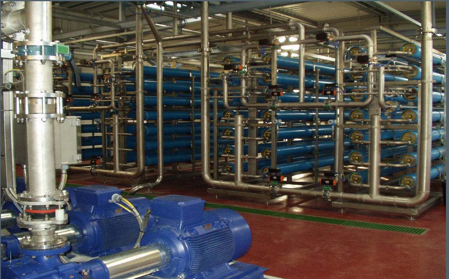
Osmoseurs inverses et pompes haute pression
