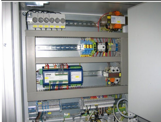
Abb. F-1 Schaltschrank
